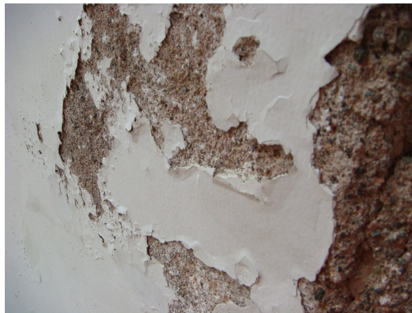
Gambar 3: Kelembaban akibat naiknya air tanah melunakkan acian gamping dan melepaskan cat — temukan dahulu sumber kelembabannya sebelum memperbaiki
