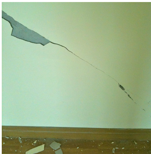
Gambar 4: Retak pada dinding lama sebelum diperbaiki
