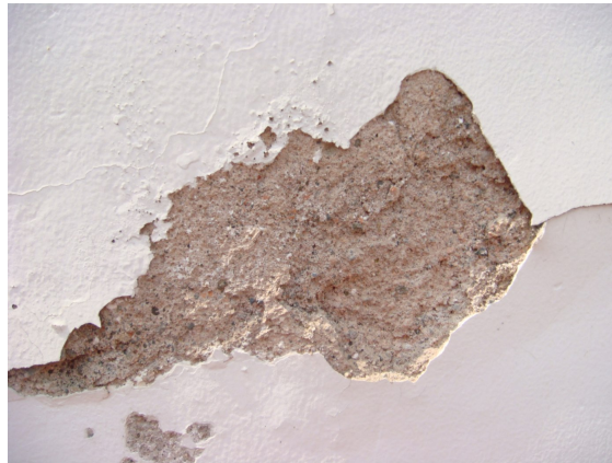
Gambar 2: Retak dan lepas akibat masuknya air ke dalam dinding, merusak plester dan acian pada bangunan lebih dari 100 tahun
